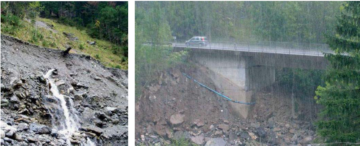
Abb. A4-19: Durch Erosion abgerissene Trinkwasserleitung (Amt der Vorarlberger Landesregierung 2005, S.23,31)
