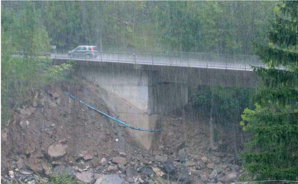
Abb. A4-7: L 200 Bregenzerwaldstraße, Sporeneggbrücke mit abgerutschter Trinkwasserleitung (Amt der Vorarlberger Landesregierung 2005, S.31)
